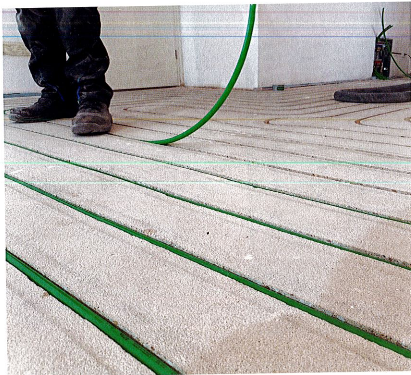
Bild 2 Gefräßte Fußbodenheizungen haben ein schnelleres Ansprechverhalten. Dies ist besonders für Hotel- und Gastronomieimmobilien interessant.
