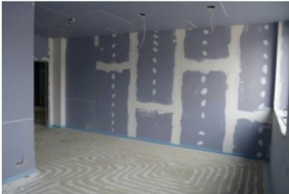
Bild 1: Der alte Estrich wurde in den meisten Etagen komplett ersetzt. Anschließend wurden die Kanäle für die Heizungsrohre hineingefräßt. (Foto: EMPUR)
